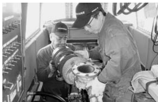
◀工場での修理のため、エンジンを取り外しているところ
